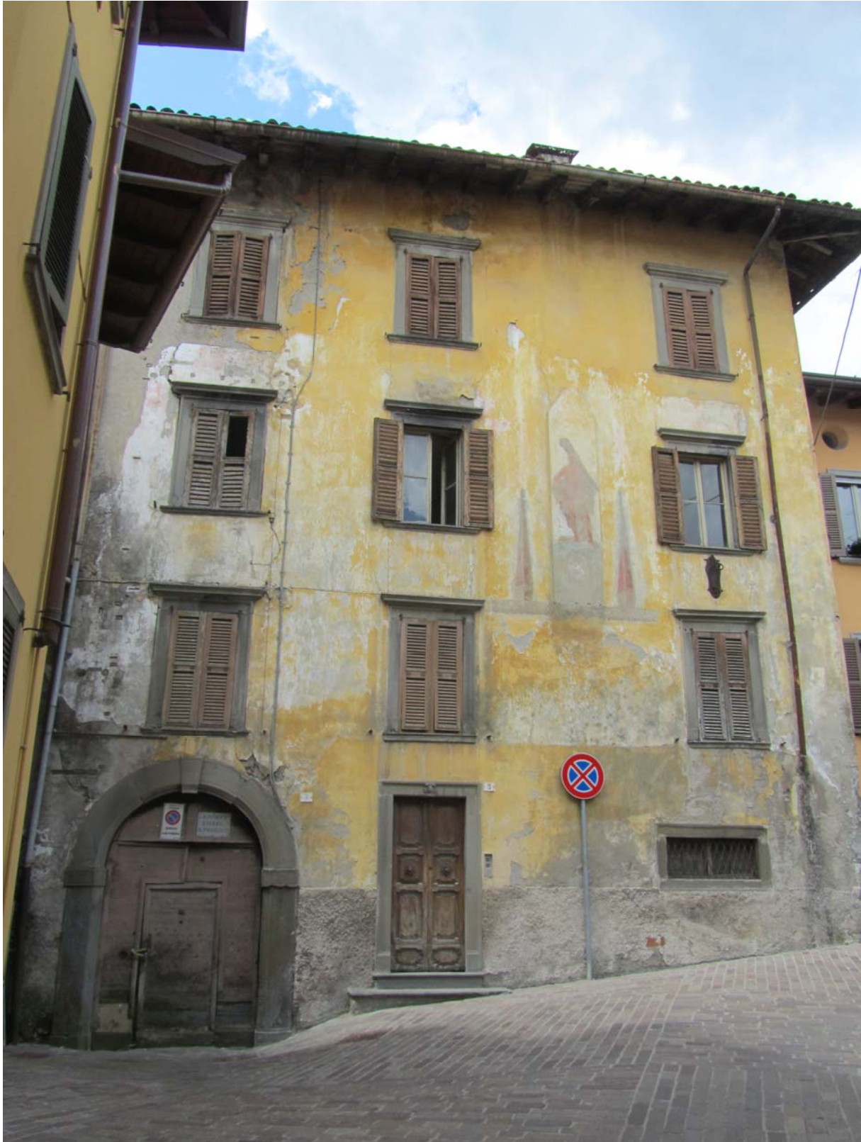
Une maison typique de Clusone. Certains de ces vieux bâtiments, des splendeurs en leur temps, accusent le poids des ans et nécessiteraient des travaux importants de restauration, tant extérieurs qu'intérieurs.
